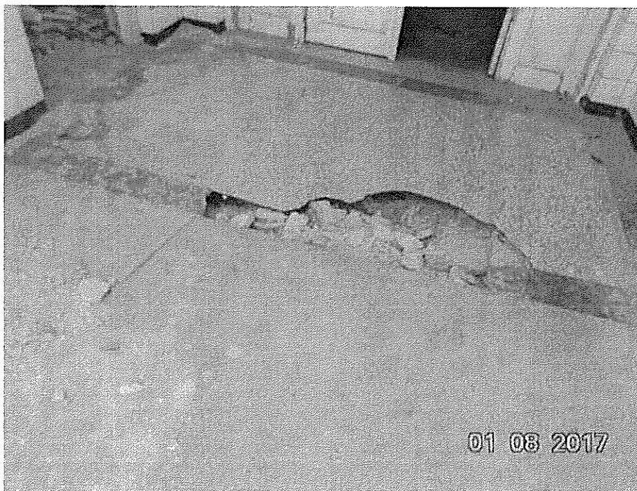
Foto 13- Tasare a pamantului pana la 30cm in interiorul corpului C2 - pe hol, pardoseala fiind partial suspendata
