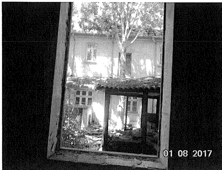
Foto 23- sarpanta si invelitoare degradata
