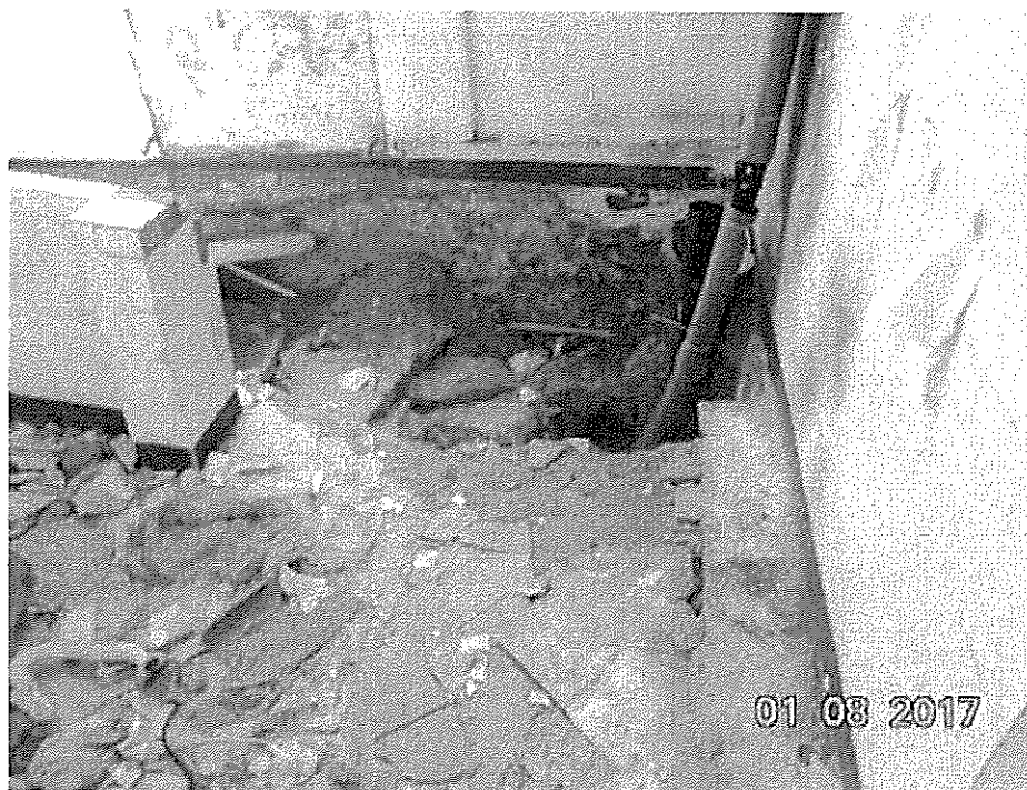
Foto 11- Tasare a pamantului pana la 50cm in interiorul corpului C2, respectiv s-a tasat pardoseala
