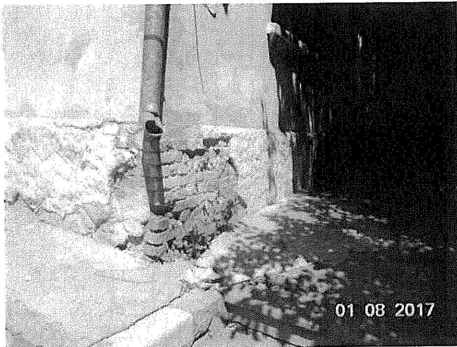
Foto 10- Fundatii din zidarie de caramida
