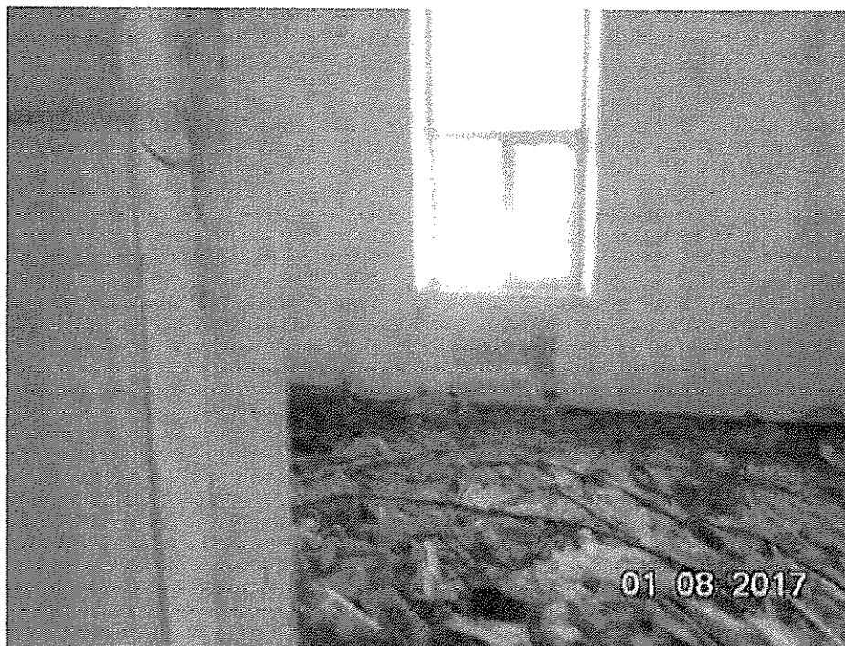
Foto 15- cladirea este ocupata de clandestin, acestia vandalizand partial cladirea (C2)
