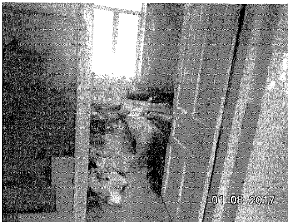
Foto 14- cladirea este ocupata de clandestin, acestia vandalizand partial cladirea (C2)
