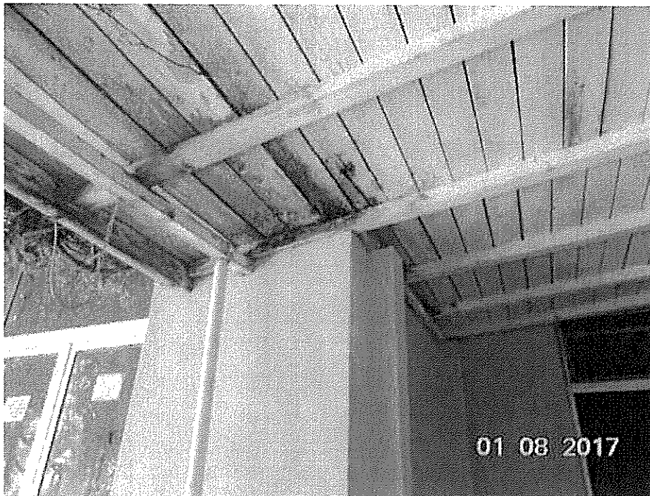
Foto 25- streasina infundata din lemn degradata
